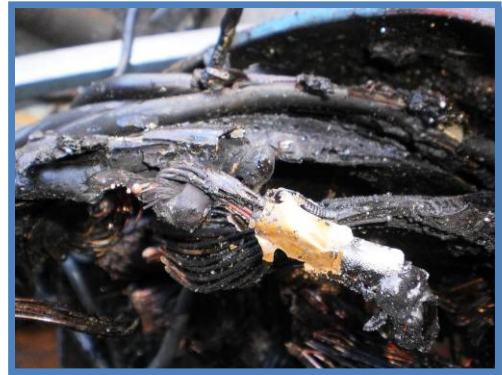
Foto 02: Curto-circuito entre bobinas.
