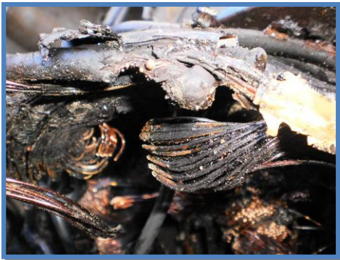
Foto 03: Curto-circuito entre espiras.
