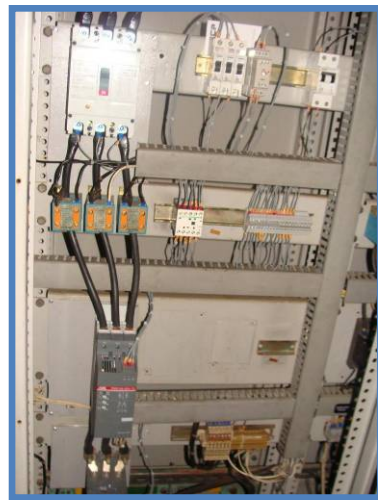
Foto 14: Vista geral do PCM “depois”.
