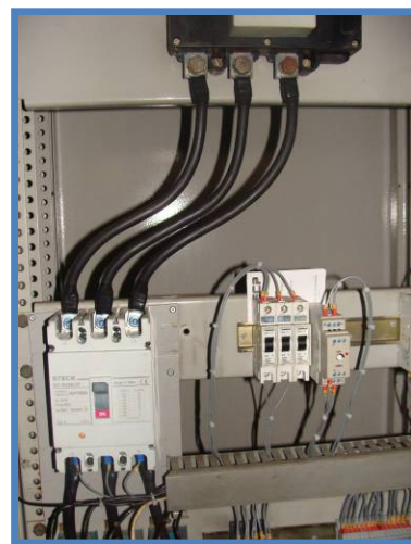
Foto 16: Circuito de potência “depois”.
