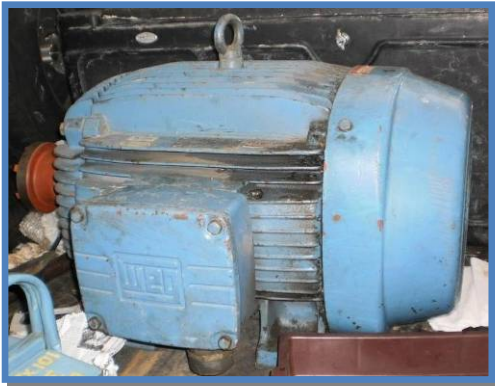
Foto 01: Motor elétrico danificado.
