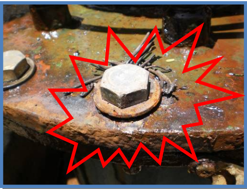
Foto 11: Evidência de curto-circuito à terra.
