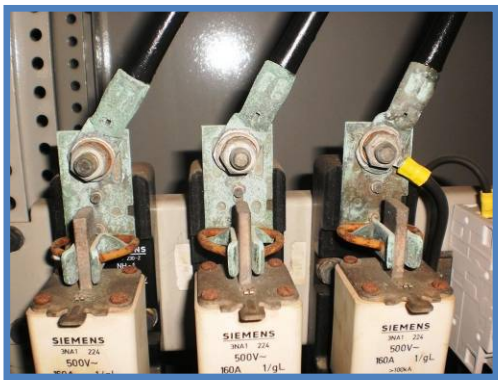
Foto 15: Circuito de potência “antes”.
